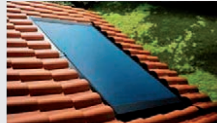
Instalação em telhado integrado
